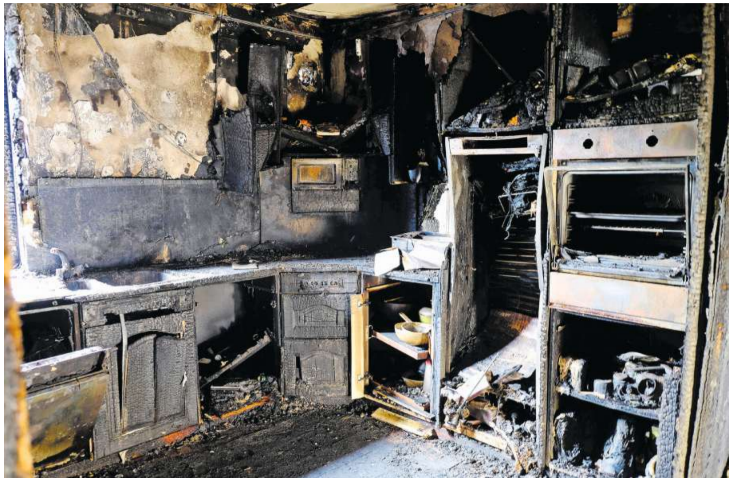
Das Feuer ist in der Küche der Erdgeschosswohnung ausgebrochen.
